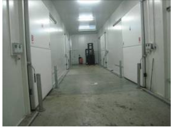
SOĞUK HAVA DEPOSU
